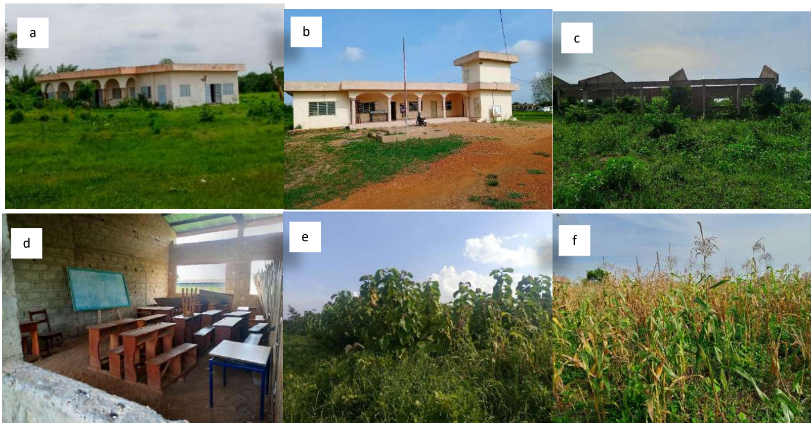
a : Bloc de salle de classe non fonctionnel ; b : Bloc administratif du lycée construit en 2014 et présentant des fissures, c : Dortoir des garçons inachevé ; d : Aperçu d'une salle de classe du LTP présentant des malfaçons ; e : Vue sur une plantation de Tectona grandis sur le site du LTP ; f : Champ de maïs d'un squatteur
