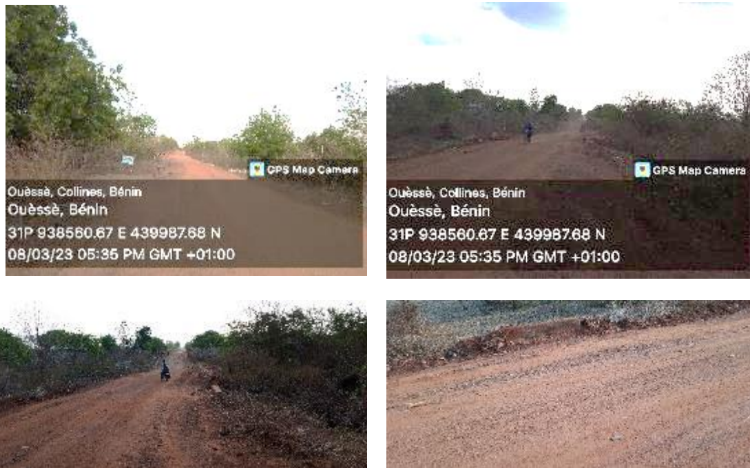
Planche 11 : Etat de la voie d'accès au site
