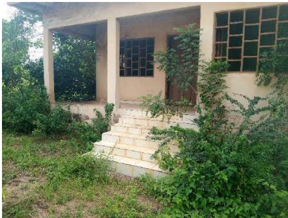
Résidence inhabitée dans un état délabré
