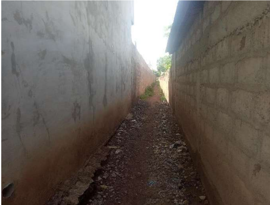
Photo 3 : Distance entre la clôture du lycée et la première habitation la plus proche
