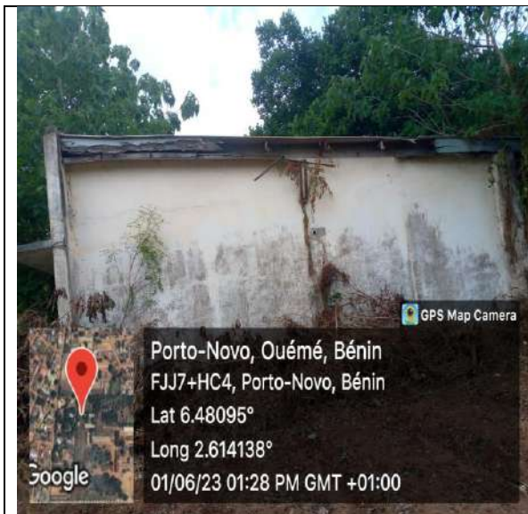
Bâtiment ENI délaissé
