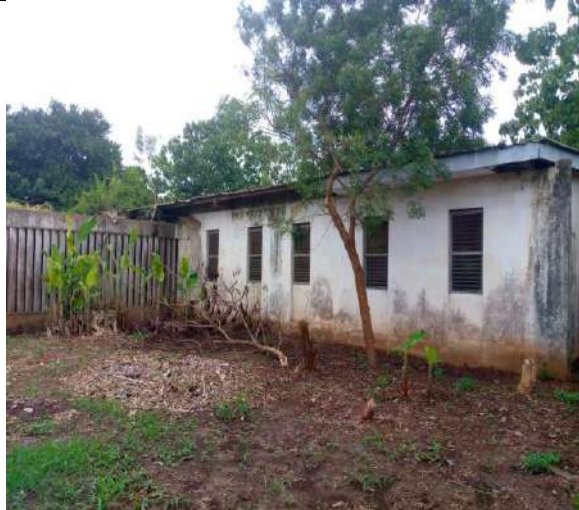
Bâtiment ENI délaissé
