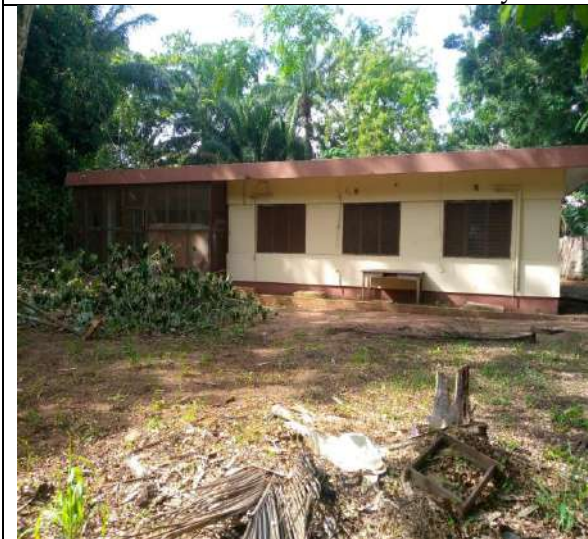
Résidence du personnel délaissée
