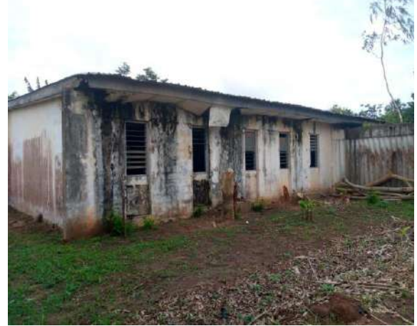
Bâtiment ENI délaissé
