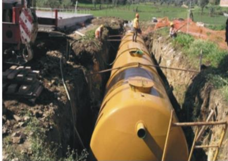
Figure 10: Dispositif de traitement des eaux usées (Step) Source : APS, ADET 2021
