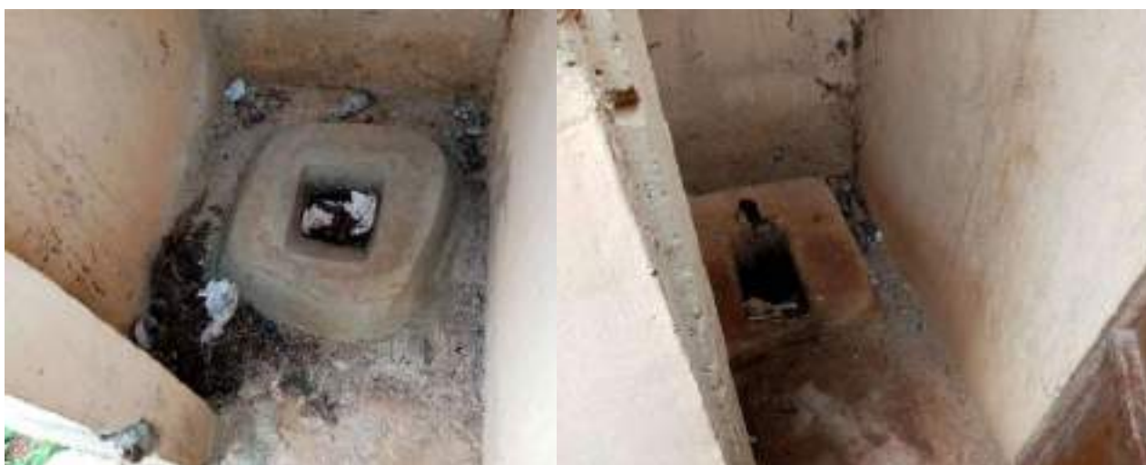
Absence de porte et orifice de latrine bouchée
