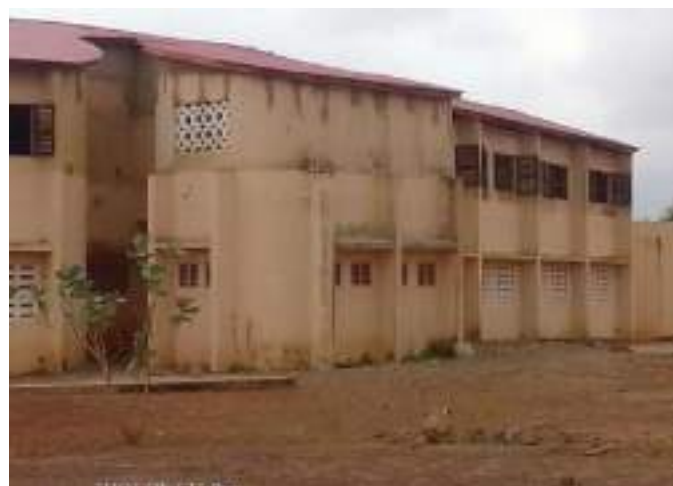
Toiture mal posée exposant le bâtiment à des fuites d'eau sur le mur
