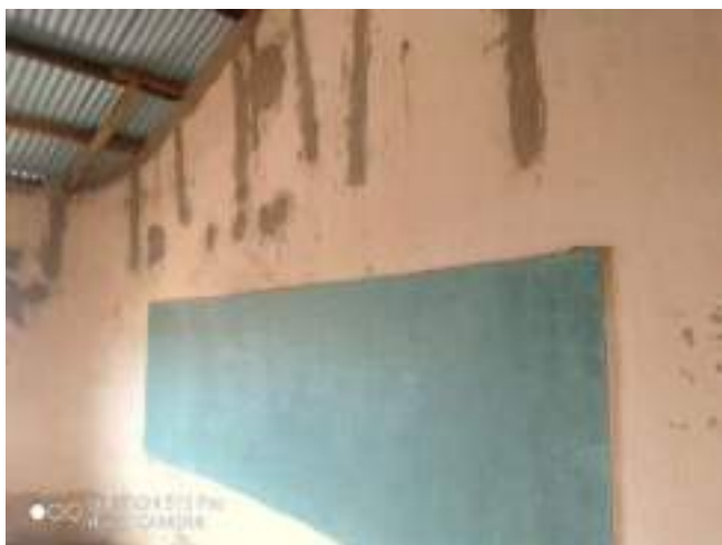
Traces de fissures corrigées sur une salle de classe
