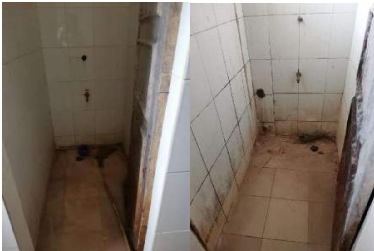
Photo 3 : Etat des douches au niveau du dortoir des garçons Prise de vue : CREDD, août 2020
