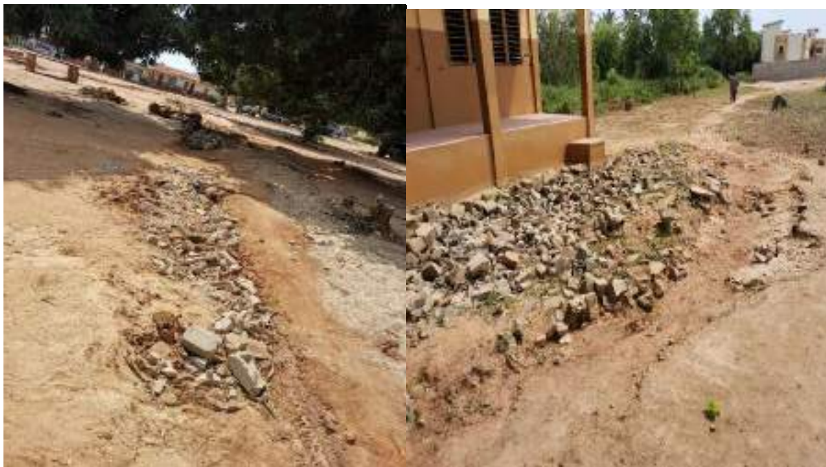
Photo 2 : Zones érodées sur le site et système de protection employé par le Lycée Prise de vue : CREDD, août 2020
